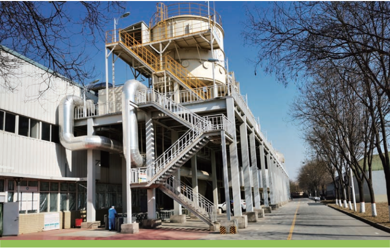
涂装废气处置设施：沸石转轮浓缩+RTO
